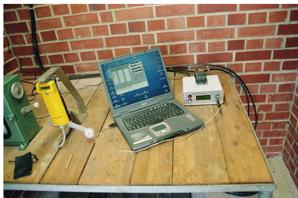
Abb. 50: Telemetriestation im LUA-Pegelhaus
