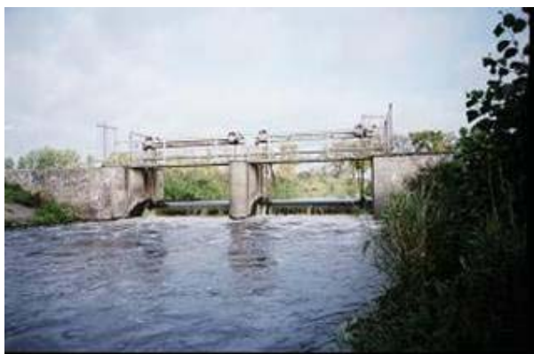
Abb. 5: Wehr DB-AG Wittenberge (vorher)
